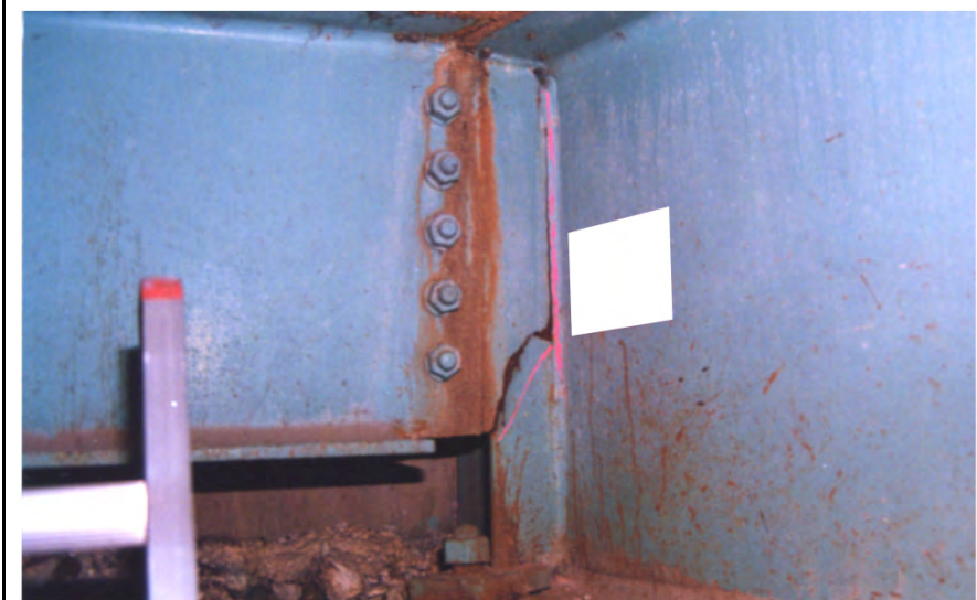
写真番号 4.1.2 説明 端横桁が、破断しているとみなせる程度に断裂した例 (注: 亀裂に沿って赤くマーキングしている。)
