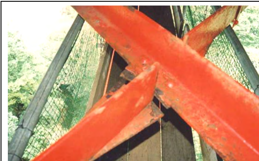
写真番号 4.1.1 説明 横構が破断した例
