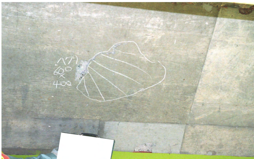
写真番号 11.1.2 説明 床版のコンクリートにうきが生じた例 (注:うきはマーキングしている部分)
