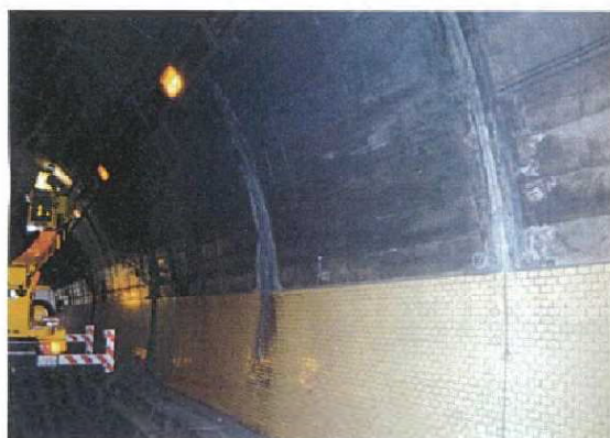
付写真-1.3.1 覆工スパンの中間付近に発生したひび割れの例
