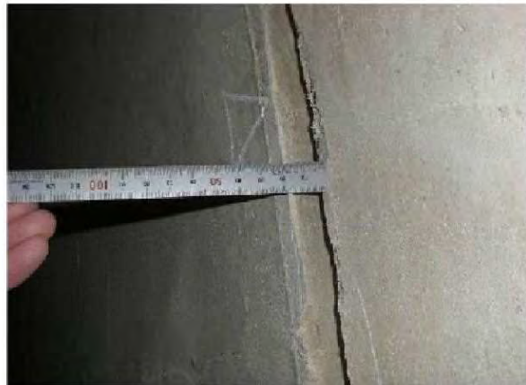
付写真-1.4.4 段差の例
