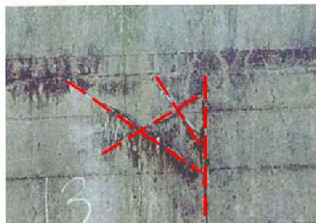
付写真-2.1.1 ブロック化したひび割れの例
