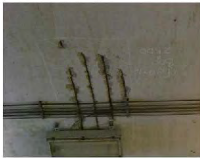
付写真-2.1.2 鋼材腐食の例
