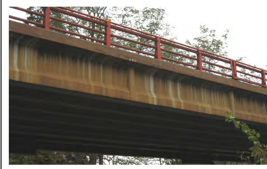
写真番号 16.1.8 説明 コンクリート表面に鉄分が付着して変色した例
