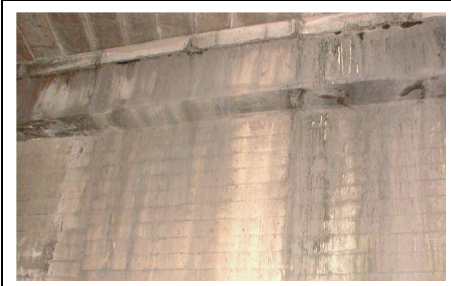
写真番号 16.1.7 説明 コンクリート表面を伝う水によって泥が付着して変色した例
