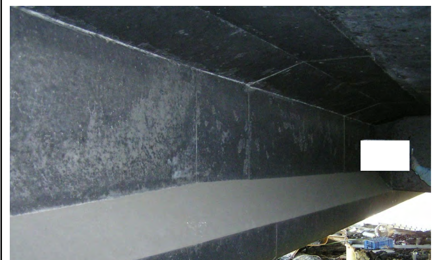
写真番号 16.1.5 説明 火災によりコンクリート部材の表面にすすが付着して変色した例
