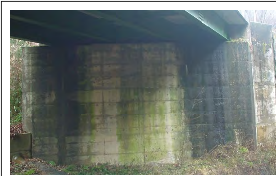
写真番号 16.1.6 説明 コンクリート部材の表面を伝う水によって苔が付着して変色した例
