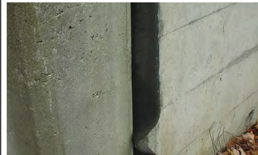
写真番号 16.1.4 説明 目地材が脱落した例
