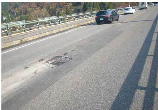
舗装に発生したポットホール
