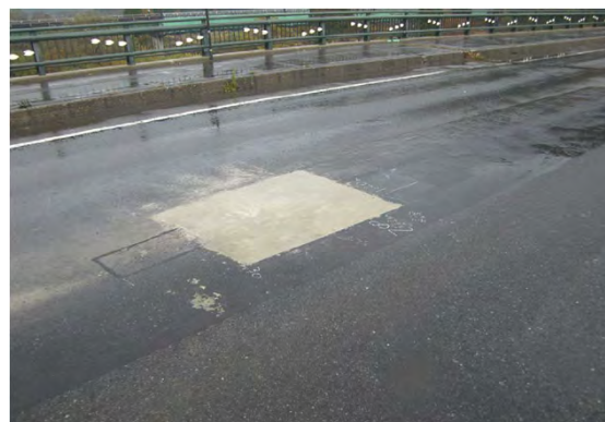
舗装損傷部の補修状況 (床版上鉄筋部までコンクリート補修)
