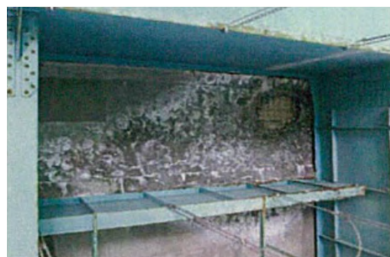
抜け落ち部の床版下面状況
