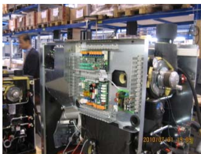
図 3.1-8 ボイラーに搭載された制御ボード
