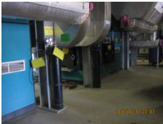
図 3.1-4 チップボイラー
