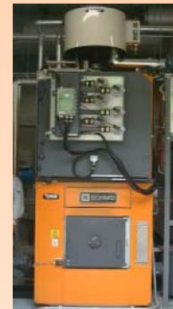
チップボイラー
