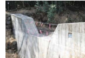
土石流センサーの設置
