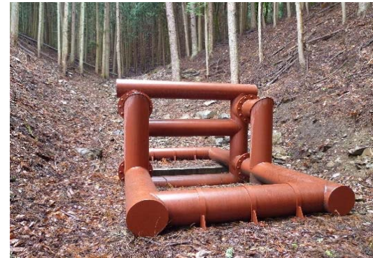
小型の流木捕捉工(山梨県甲州市)
