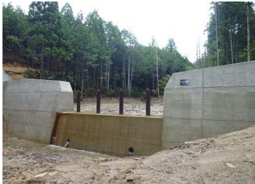
流木捕捉式治山ダム(滋賀県大津市)
