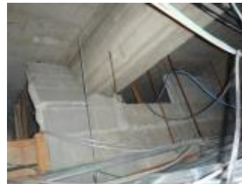
天井内コンクリ壁の倒壊
