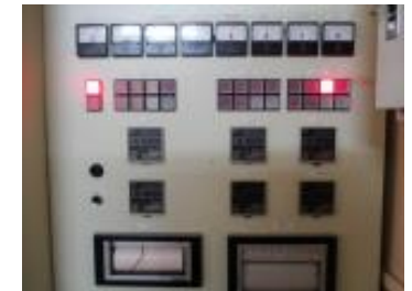
基盤等の破損により漏電警報ランプのみ作動
