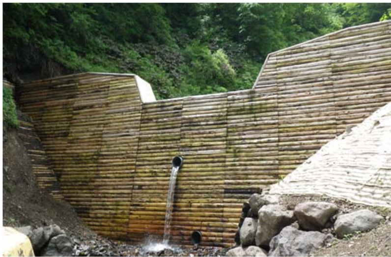
治山工事の残存型枠（福井県今立郡）
