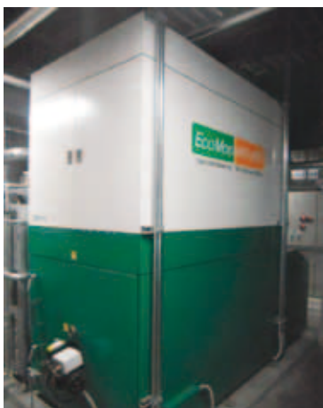
チップボイラー
