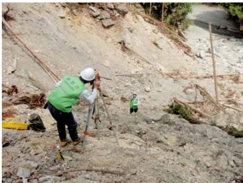
写真1 山地災害緊急展開チームによる現地測量の様子
