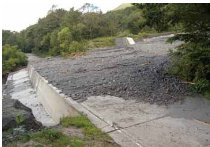
③ 豪雨後の県道への土砂流出状況（二の沢）
