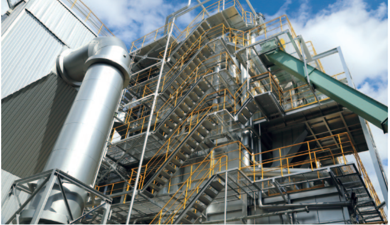
那珂川バイオマス発電所
