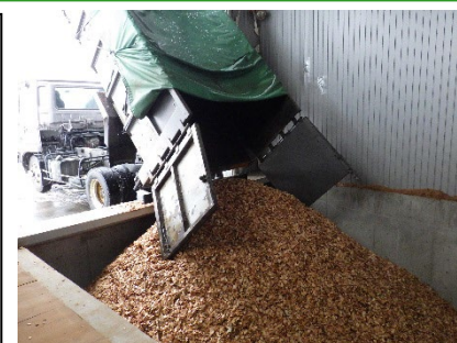
木質バイオマスボイラーに搬入する様子
