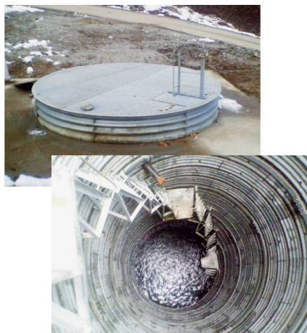
集水井工（外観及び内部）
