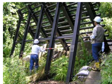
中越沖地震直後の治山施設の点検 〔新潟県柏崎市〕 関東森林管理局 中越森林管理署
