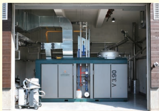
木質バイオマス発電の設備
