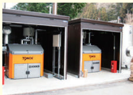
設置された薪ボイラー
