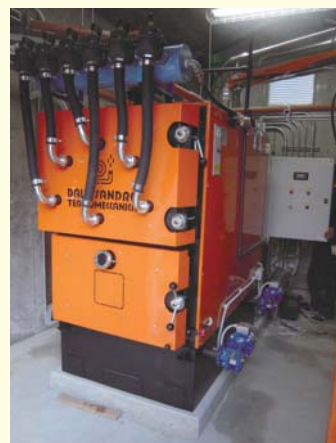
導入された木質チップボイラー
