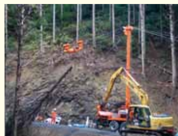
新たに導入したオーストリア製のタワーヤードと搬器
