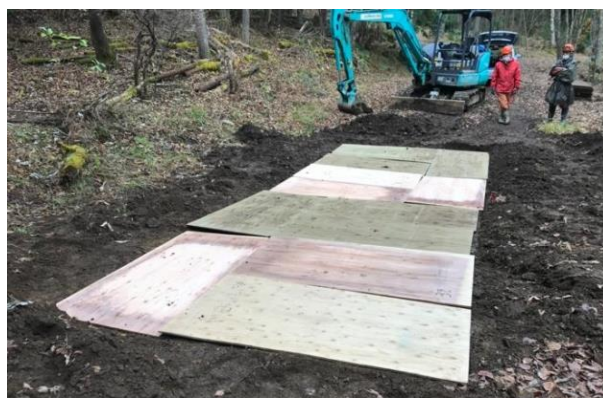
写真 1 構造用合板の敷設状況（埋戻し直前） （掘削深さ 100mm、2020 年 11 月施工）
