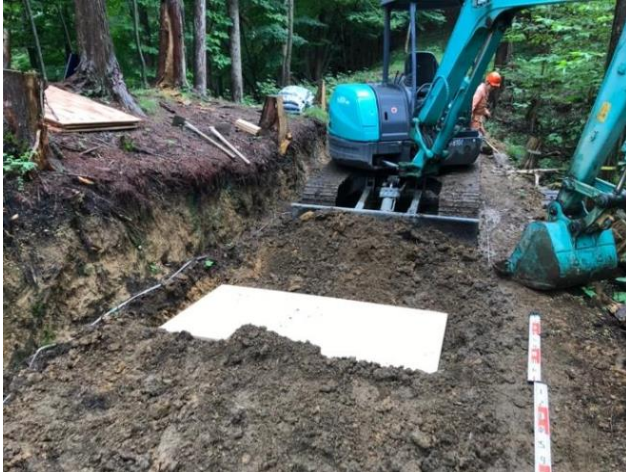
写真3 幅員 2.5m の作業道における施工試験 (区間 C、敷設した合板の埋戻し作業中)
