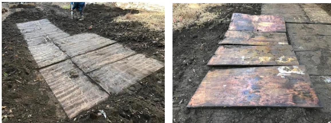
写真2 施工1年後に回収した合板を掘り出した直後の状態（掘削深さ100mm） （左：表面の状態、右：裏側の状態）
