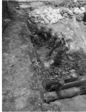
大型台風によりワサビ田が陥没
