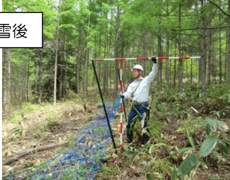
写真2 防護柵（斜め張り方式）使用における積雪による影響」（支柱が傾斜）
