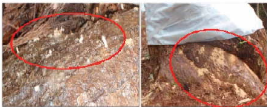
写真-6 カシナガブロックから飛び出した跡
