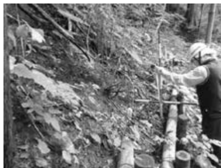
(写真-2) 土砂堆積状況調査
