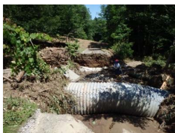
林道被害調査の様子
