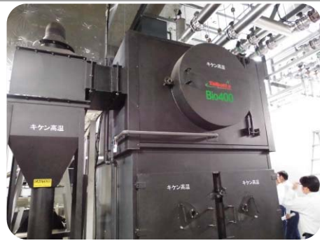
地元小学校のバイオマスボイラー
