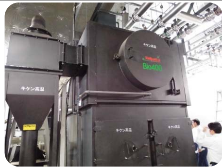
地元小学校のバイオマスボイラー
