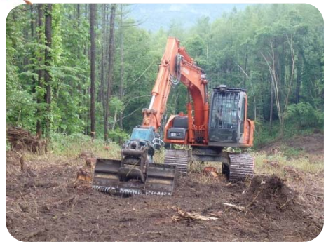
⑤伐採時に使用したの重機でササ等を除去し、地拵え時の重機運搬経費を削減
