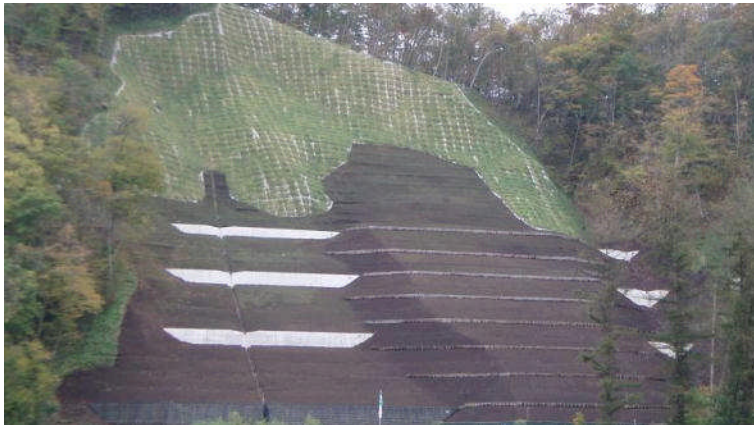
山腹崩壊を防止するための治山施設 （日高南部森林管理署管内）
