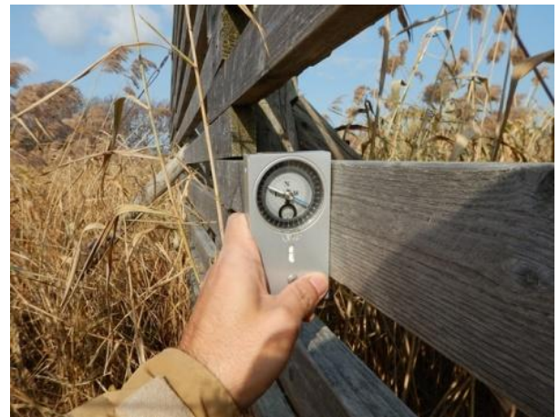
平成 26 年 傾斜状況(1°)
