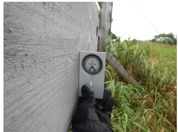
平成 27 年 傾斜状況(1° )
