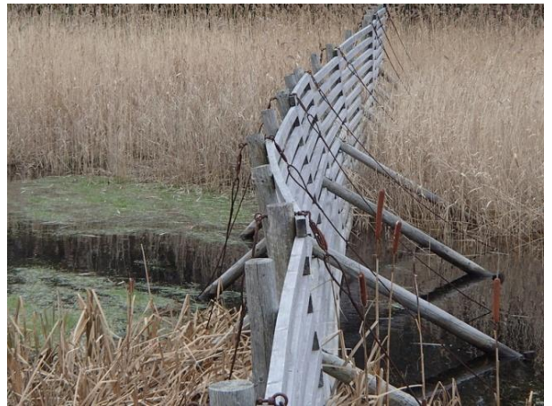
平成 25 年湿原側に傾斜している
