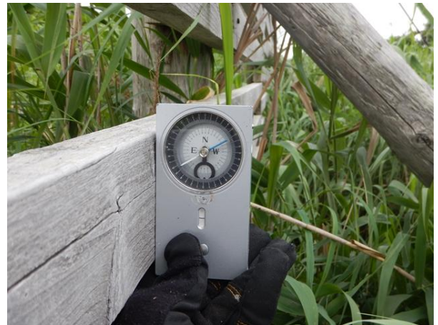
平成 27 年 傾斜状況(1°)
