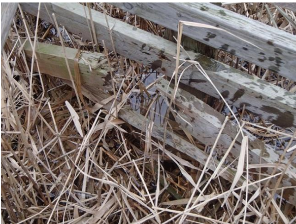
平成 25 年 柵の沈下に伴う横板の破損
