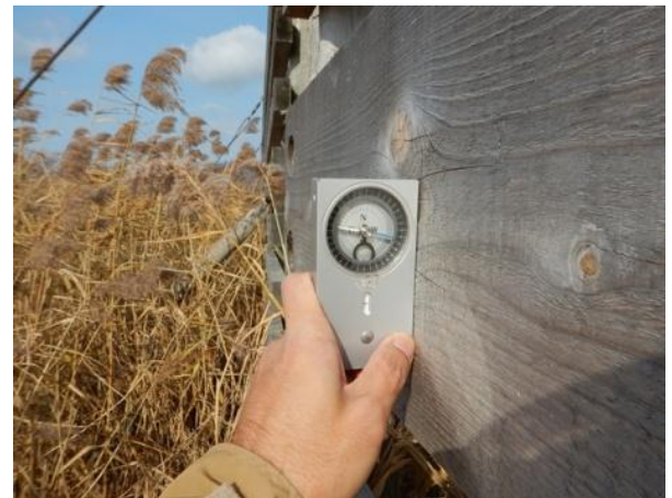
平成 26 年 傾斜状況(1° )
