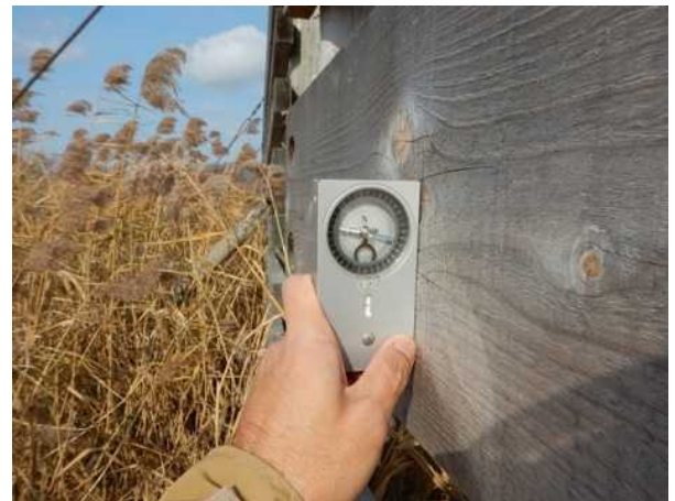
平成 26 年 傾斜状況(1°)
