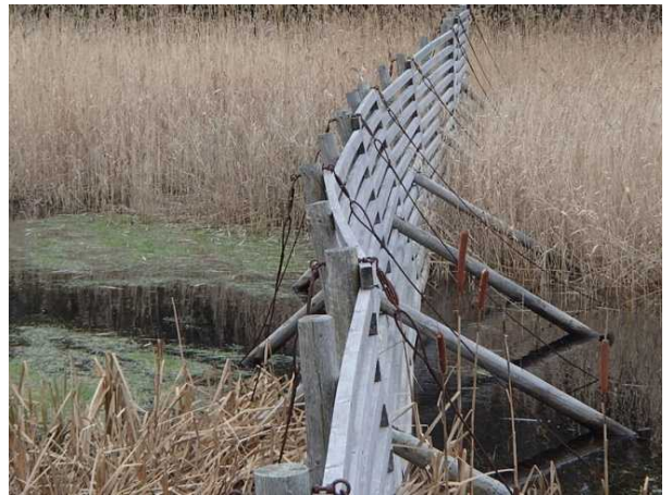
平成 25 年湿原側に傾斜している
