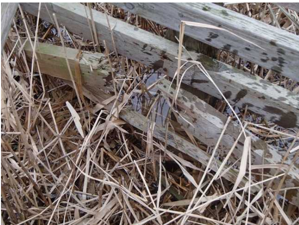
平成 25 年 柵の沈下に伴う横板の破損
