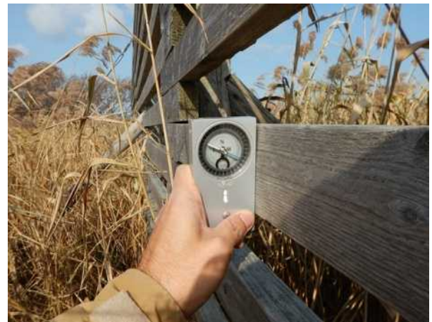
平成 26 年 傾斜状況(1°)
