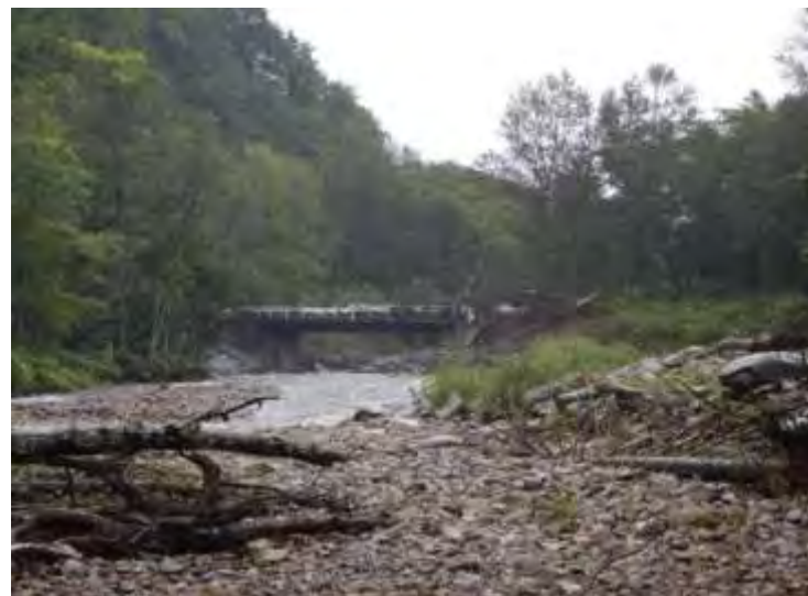
美生川流域の橋梁の状況 (268林班上美生2の沢林道)
