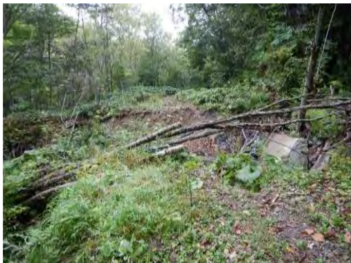
戸蔦別川林道の決壊状況 (289林班三ノ沢)
