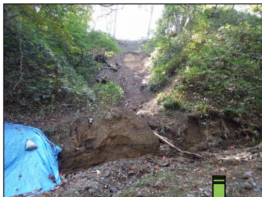
(施工前)山腹崩壊箇所
