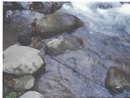
玉石連結ワイヤーの露出 (H22 年 10 月)
