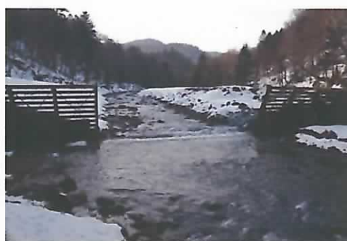
土砂流出後 (H22 年 12 月)
