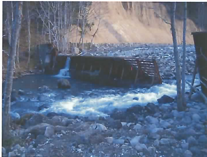
写真 4-1 赤イ川 H18 改良治山ダム (No. 11)
