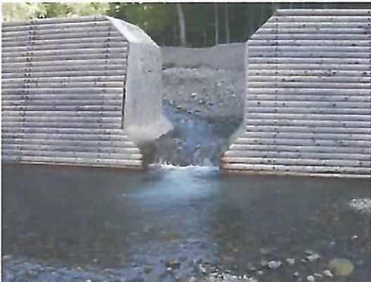
ピリカベツ川 H19改良ダム(No.8) スリット部 落込みの水深は約60cm
