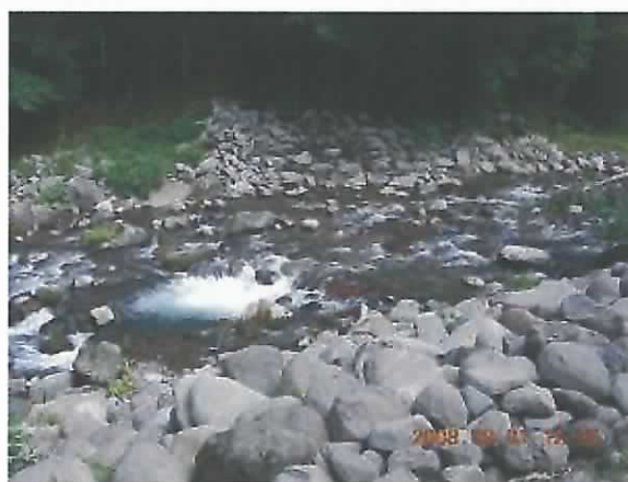
写真 4-1 赤イ川 H18 改良治山ダム (No.11)
