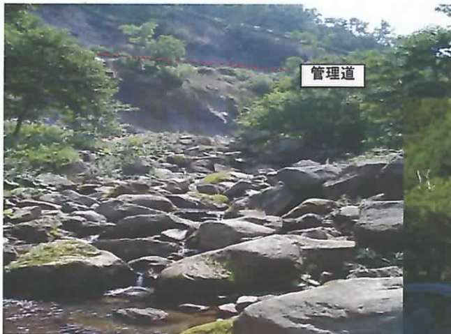
上流部の管理道と法脚浸食状況
