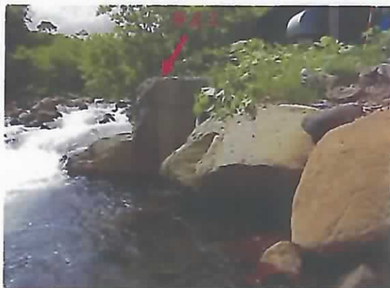
下流より望む。本体が破損して落差なしとなっている。
