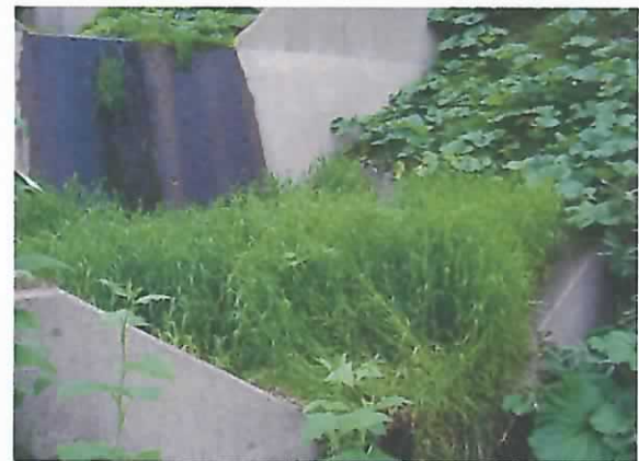
上流のコンクリート叩の状況。土砂が溜り草が生えている。
