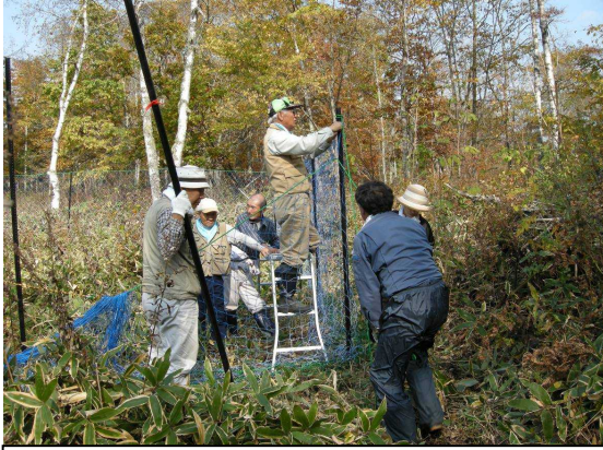
高さ2.0mのエゾシカ食害防護柵を手順よく設置しています。
