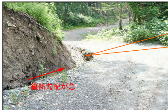
側溝が洗掘された例
