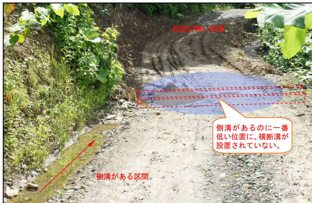
横断溝が適切な位置に設置されていない側溝の例
