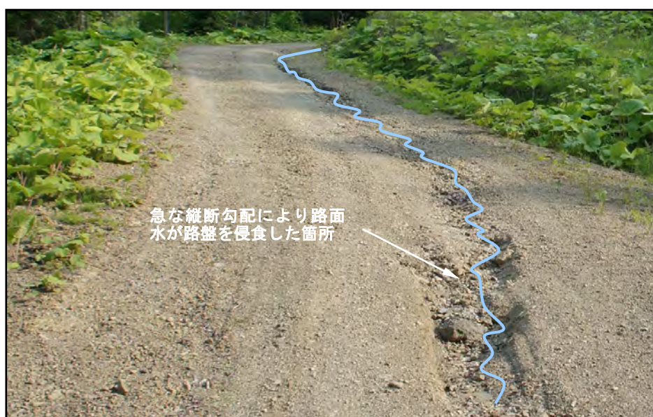
路面水が路面を侵食した例
