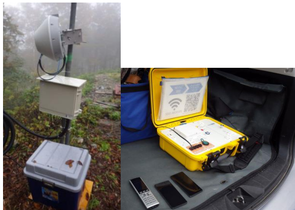
試験導入を行った通信機器
