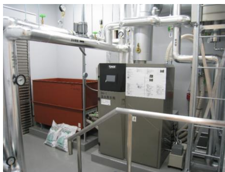
ペレットボイラー(南木曾支署)
