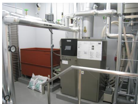
南木曾支署(ペレットボイラー)
