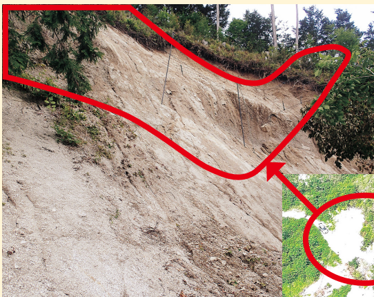
真砂土地域の防護柵の損傷状況
