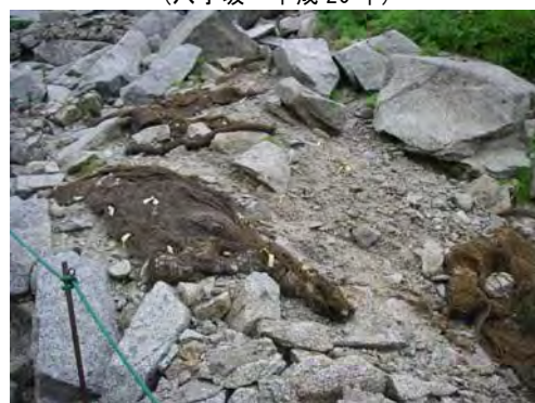
マットがはがれた状態 (八丁坂 平成 23 年)
