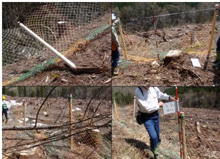
写真-5 損傷した防護柵
